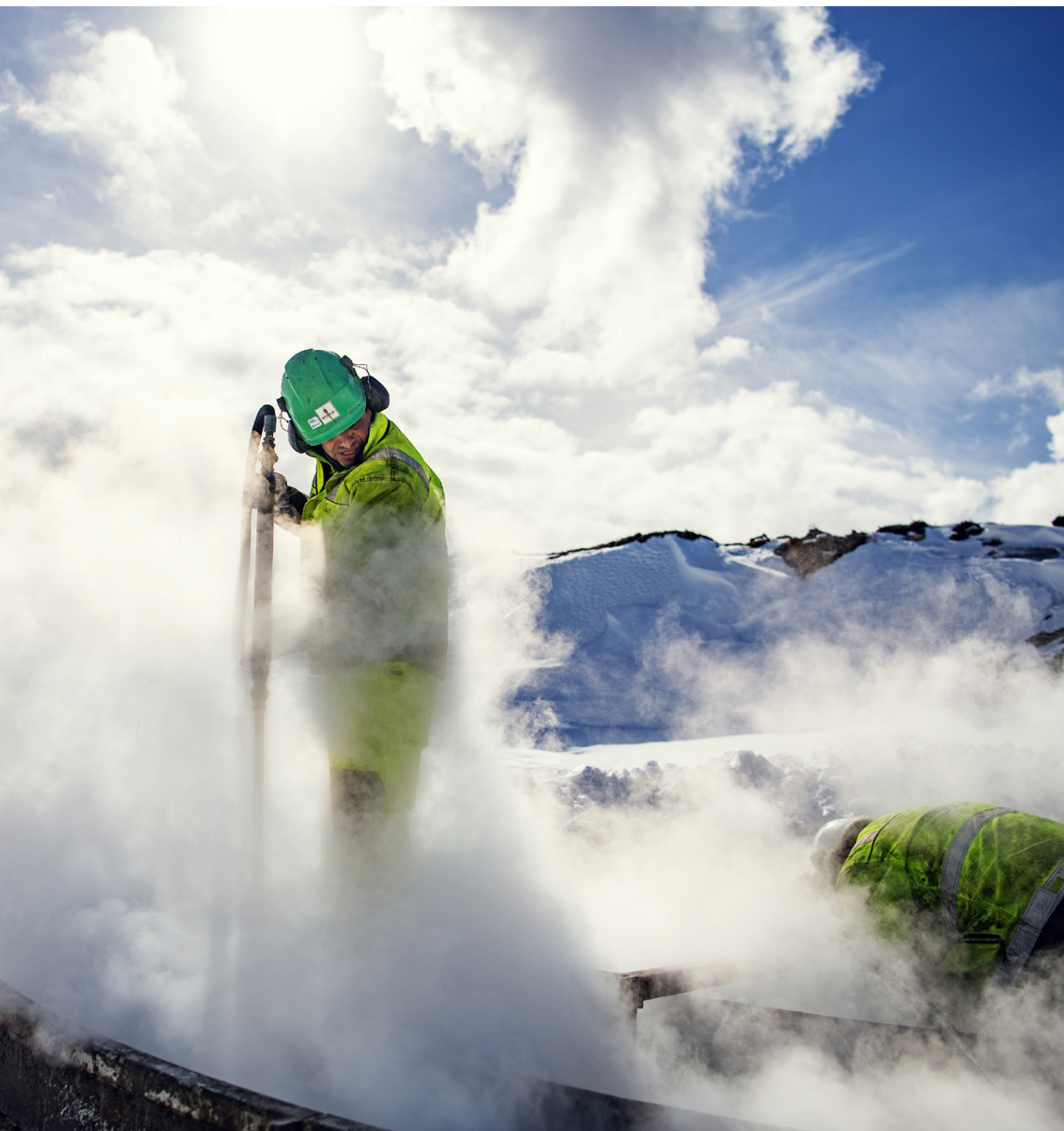
Utbyggingen av Roan kraftverk på Fosen.
