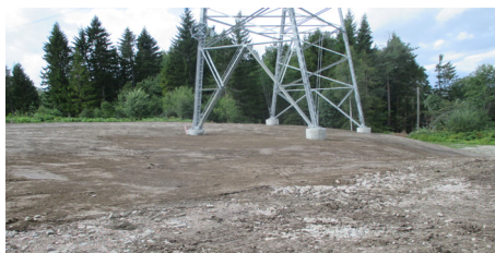
Figur 28: Mastepunkt som er tilbakeført som en stor glatt flate. Her burde flaten vært brutt opp ved å lagd forhøyninger og forsenkninger. I tillegg burde det vært plassert ut vegetasjonstuer for at naturlig vegetasjon raskere kan reetableres.
