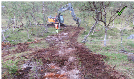
Figur 34: Ved uttransportering av maskiner og utstyr, skal kjørespor legges i gjenn og pusses. Gjennlagte spor skal ikke på nytt benyttes uten avklaring med Statnett
