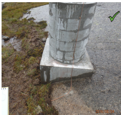
Figur 23: Korrekt utført jording. Ledningen er festet langs fjellet, for den går ned i jord.
