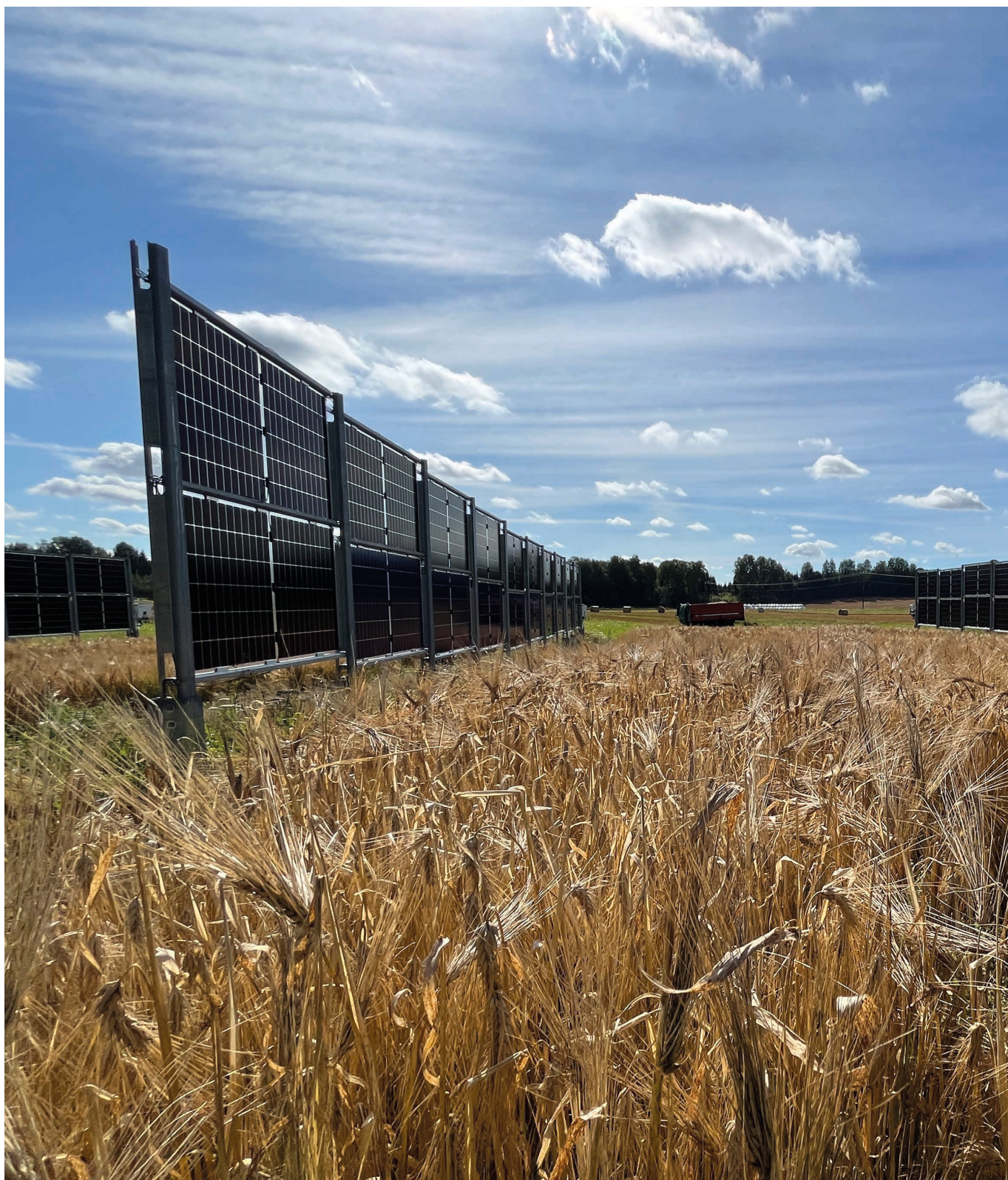
Vertikalt montert solcelleanlegg hos NMBU på Ås - Bilde: IFE
