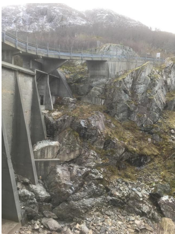
Figur 44 Eksempel som viser sprekkesystemer med ulik orientering og utstrekning i damvederlag.
