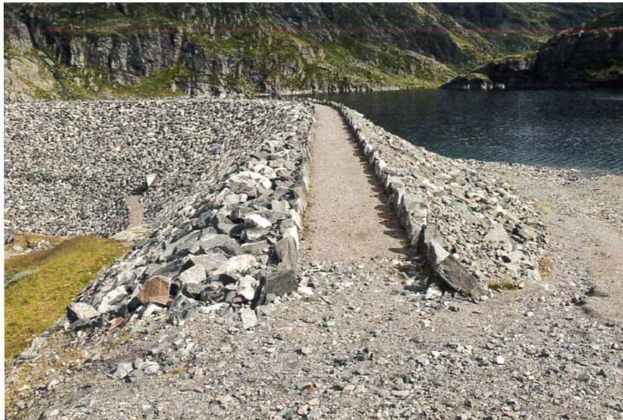
Foto A6. Damkrone, Dam Dravladalen, før rehabilitering (Foto: Statkraft)
