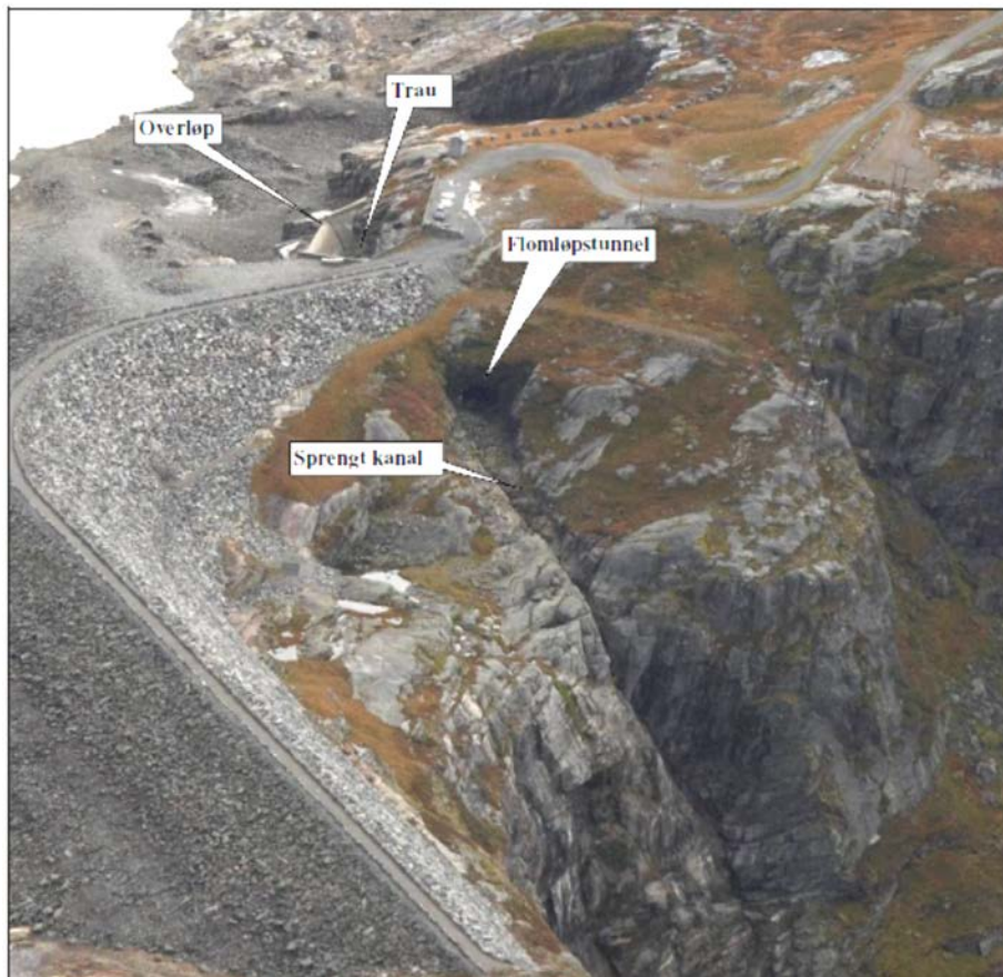
Foto A7. Flomløp, tunnel og kanal på Dam Dravladalen (2010, før rehabilitering) (Foto: Statkraft)
