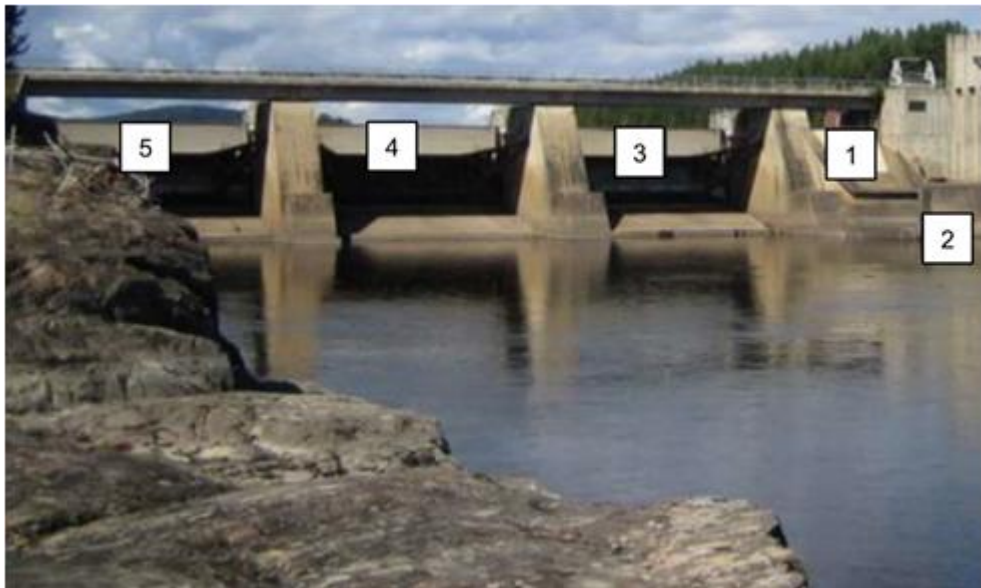
Nummerering av luker iht. styringssystem. Fotoillustrasjon SWECO (stemmer ikke med revurdering og tilsynsrapporter)
