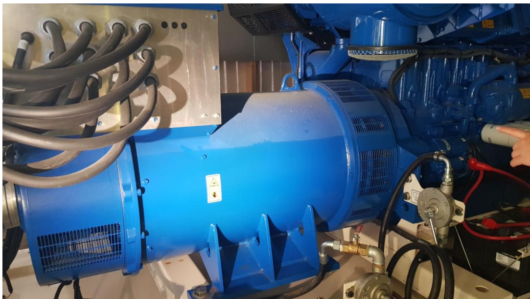
Vannstand, generatorsett – nødstrømsanlegg. Foto DNV
