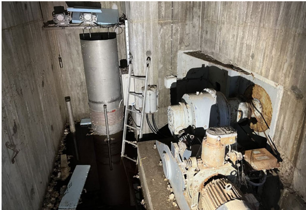
Bilde 15 Lukehus i pilar, med maskineri som ble satt under vann. Bildet er tatt etter at det meste av vannet er drenert ut. Vann kan fortsatt ses i bunnen av huset (Foto DNV)
