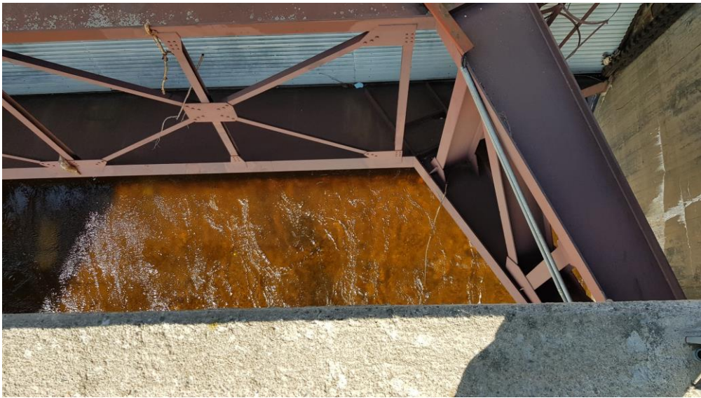
Når platedragerne og lukebein «fylles» med vann gir dette vesentlig tilleggslast på opptrekket.
