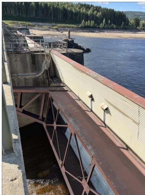
Foto som viser lukeposisjon slik de var under flommen. Topp luker i flukt med pilarene. Foto: DNV.
