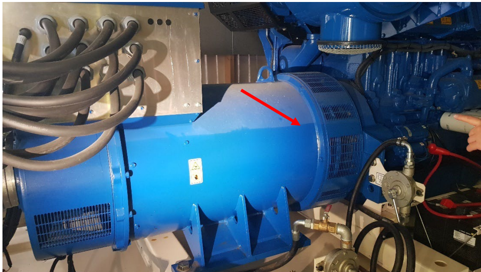
Bilde 17 Nøddaggregatet druknet. Linjen oppe på generatordekslet viser skillet der vannet nådde på det høyeste, merket med rød pil (Foto DNV).
