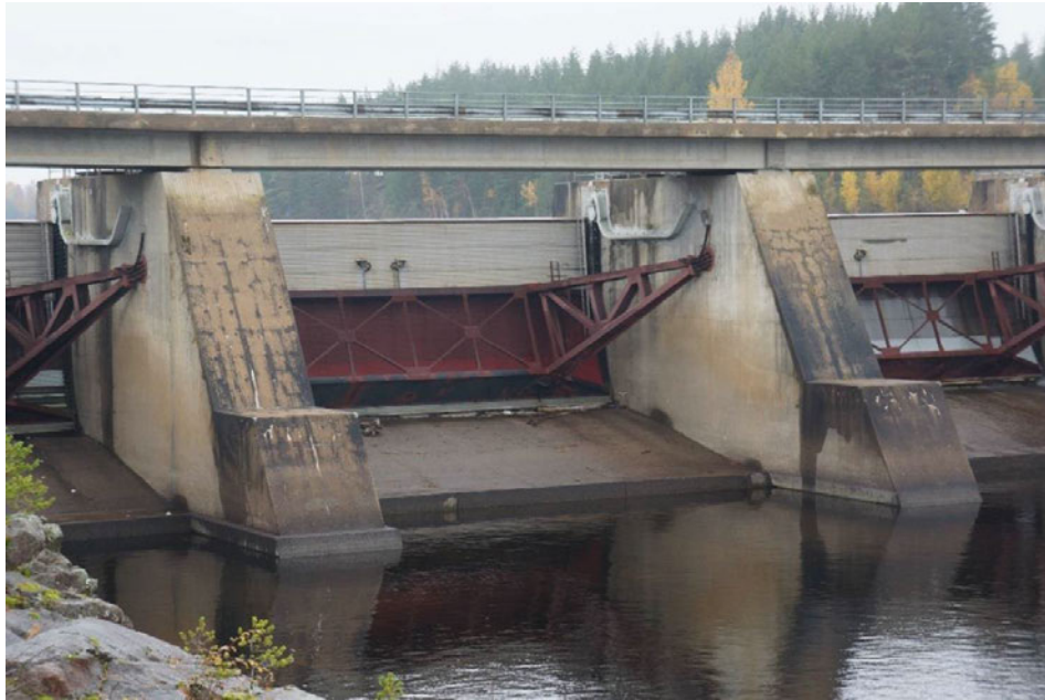
Bilde 5 Flomluke 4 i lukket posisjon (Foto Sweco)
