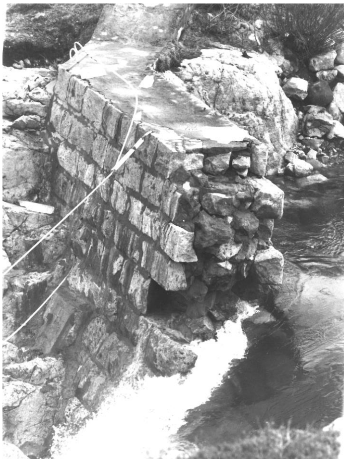
> Figur 3-13. Dam Tårnet, 4 timer etter bruddet i 1979 (Foto: NVE).
