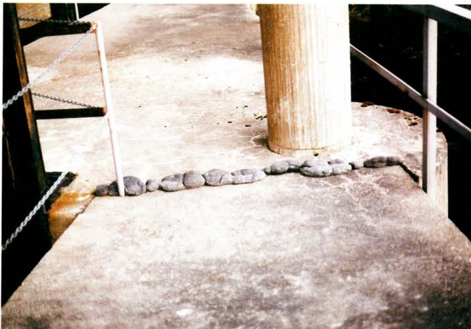
Foto 2 Fugemateriale presset ut av fugen pga ekspansjoner i betongkonstruksjonen
