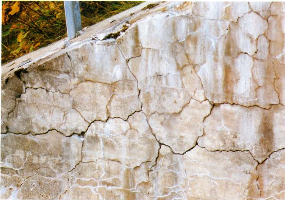
Foto 1 Krakkelering i en ledevegg pga AAR
