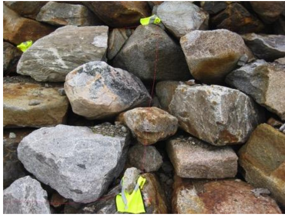
Figur 16 Området med store forskjell i steinstørrelse og dårlig kontakt mellom plastringsstein. Gjømmervatn sperredam øst.
