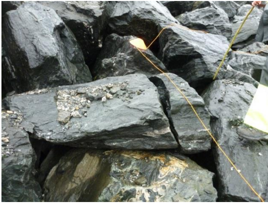
Figur 15 Oppsprukken plastringsstein som dessuten ligger med a-aksen på tvers og i dårlig forband. Dam Kvittingvatn.
