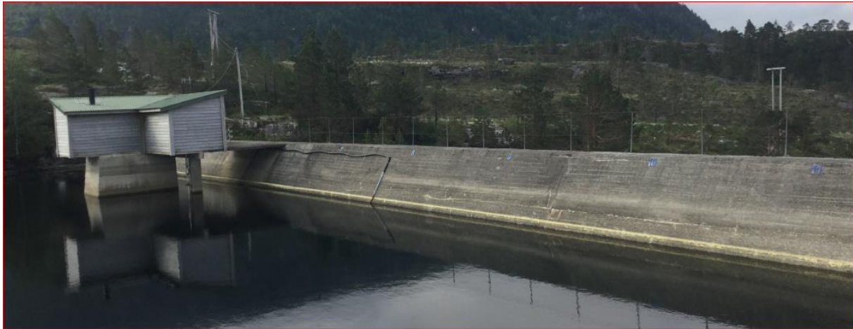
Figur 5-1 Betongplatedammen ved Nedre Botnavatnet, Osterøy, ble dimensjonert uten hensyn til islast.
